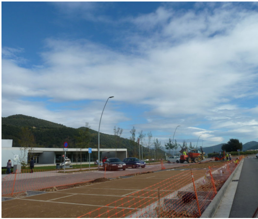
Un detall dels treballs de millora urbanística que s'estan duent a terme a l'accés a l'hospital d'Olot. Foto: J.C.
