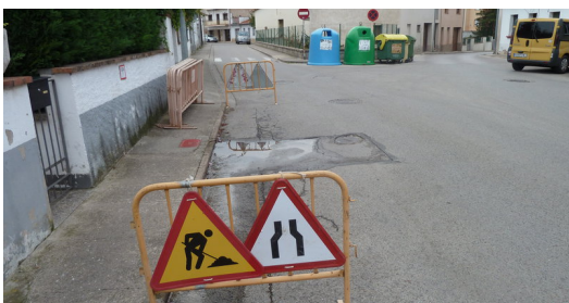
Un detall de la zona de la carretera de la Pinya de Montolivet, on es va produir la fuga d'aigua. Foto: J.C.
