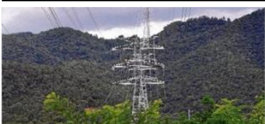
Algunes de les torres de la MAT a la zona de Bescanó, en una imatge d'arxiu.
