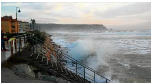
Una imatge del forat que ha provocat el temporal al passeig dels Griells de l'Estartit.
