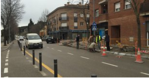
Els treballs consisteixen en eixamplar la vorera d'una de les cantonades de la cruïlla Foto: J.N.
