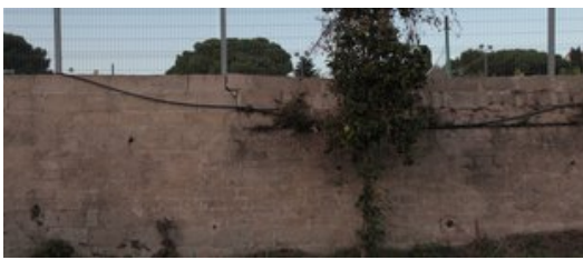
El mur esquerdat, a la pista de l'escola pública Pedralta de Santa Cristina d'Aro. Foto: EMILI AGULLÓ.
