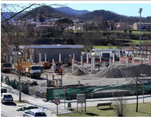
Inici de les obres del Mercadona a l'antiga fàbrica de Can Domènech, a Olot. Foto: MANEL LLADÓ.
