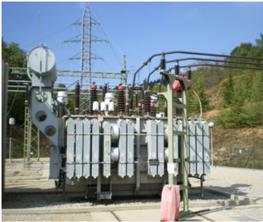
Imatge de la subestació d'Endesa a Sant Hilari on s'ha col·locat el nou dispositiu de telecontrol Foto: EL PUNT AVUI.
