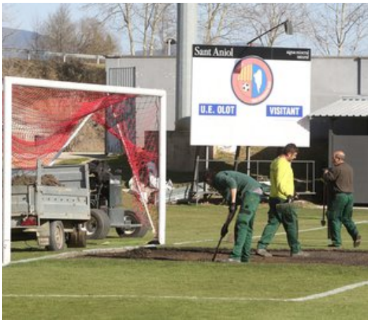
Operaris replantant la gespa de les àrees petites i l'enderrocament de la fàbrica. Foto: J. CASTRO / ICONNA.
