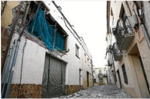
Estat en què va quedar l'edifici després de l'explosió que es va produir la nit de dissabte.
