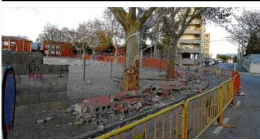
La tramuntana va tirar a terra una part del mur que envolta l'escola Salvador Dalí, de Figueres. La zona afectada es va protegir amb tanques.
