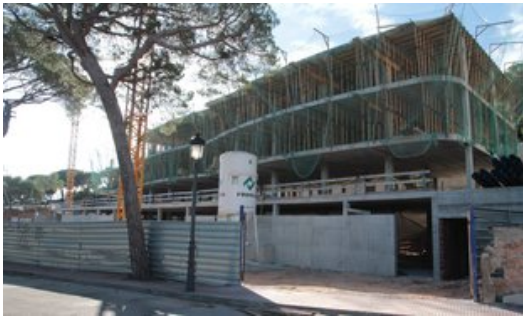
L'estructura del nou apartotel ja està parcialment aixecada a la carretera guixolenc de Sant Pol Foto: E.A.
