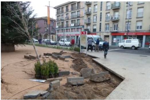
El Parc dels Coloms, ahir al migdia, quan els operaris responsables de les obres van començar a arreglar els desperfectes. Foto: J.C.
