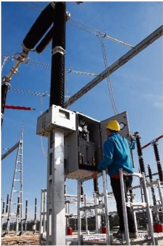
Un operari revisava les instal·lacions ahir al matí, a Santa Llogaia.
