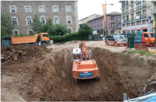
Una de les retroexcavadores treballant al futur accés del pàrquing subterrani de la plaça mercat d'Olot. Foto: J.C.
