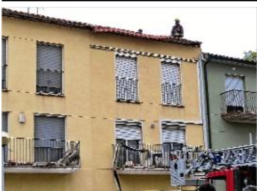
Cau una cornisa a la rambla Anselm Viola de Torroella
