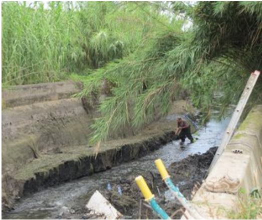
Un operari treballant en la reparació de l'esquerda a la sèquia el 19 d'agost passat Foto: J.N.
