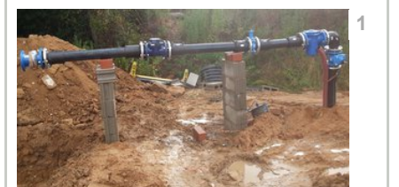
Una imatge dels treballs de connexió de les canonades de Rec Madral amb les de Caldes, la setmana passada Foto: EL PUNT AVUI .
