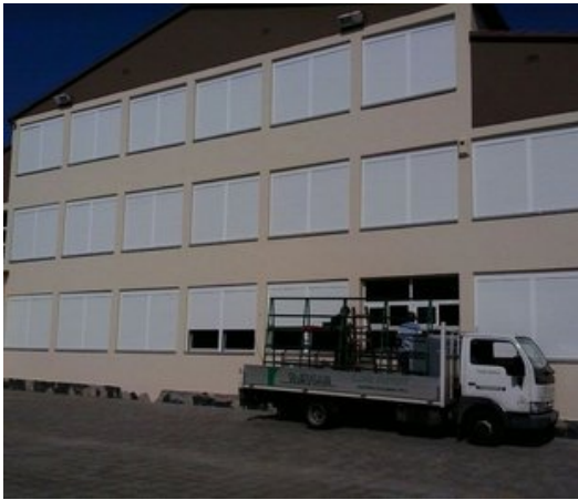
Una imatge de les recents obres de pintura de la façana de l'escola Josep Madrenys de Vilobí d'Onyar. Foto: EL PUNT AVUI.
