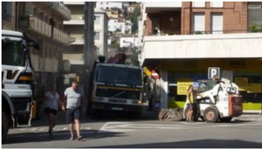
Els treballs a la cantonada entre el Pare Roca i el Pere Llosas, ahir al matí. Foto: R. E.
