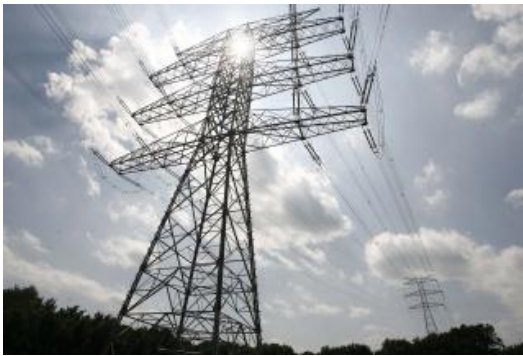
Dues torres de la MAT, amb els cables completament estesos, al seu pas per Cartellà · Aniol Resclosa
