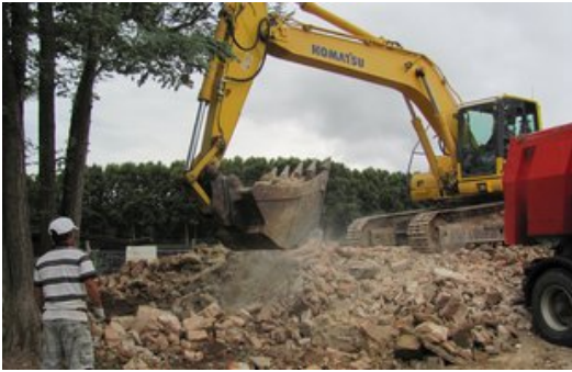
Una excavadora recollia ahir a la tarda la runa de l'antiga estació de Bescanó. Foto: D.V.
