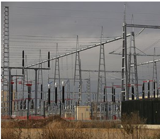
La zona de les subestacions de Santa Llogaia. La d'Endesa ha d'anar al costat de la subestació aèria de REE, que és la que es veu en primer terme a la imatge Foto: M. LLADÓ.
