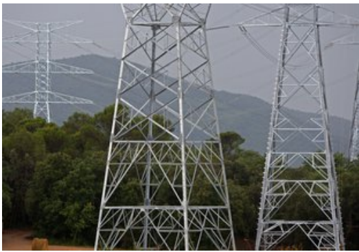
Torres de la MAT, ahir a Vilademuls Foto: LLUÍS SERRAT.
