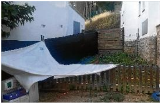
L'edifici del menjador, tancat pel risc de desprendiments.
