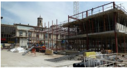
Una vista de l'estat de les obres de construcció de la nova plaça Mercat, amb l'estructura ja molt avançada. Foto: J.C.
