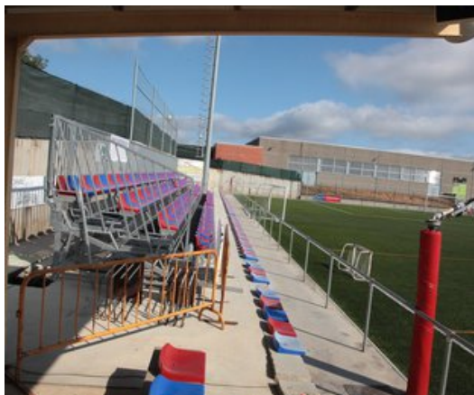
A la foto, un moment de la instal·lació de la coberta de tribuna l'estiu passat Foto: J. SABATER.
