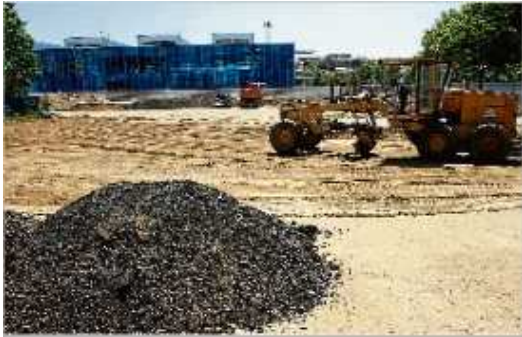
Imatge de treballs a l'aparcament de la piscina municipal, ahir a Lloret.
