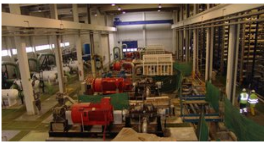
Aspecte de l'interior de la dessaladora de Blanes, que abasteix municipis del Maresme, Blanes, Lloret i Tossa. Foto: O. MAS.
