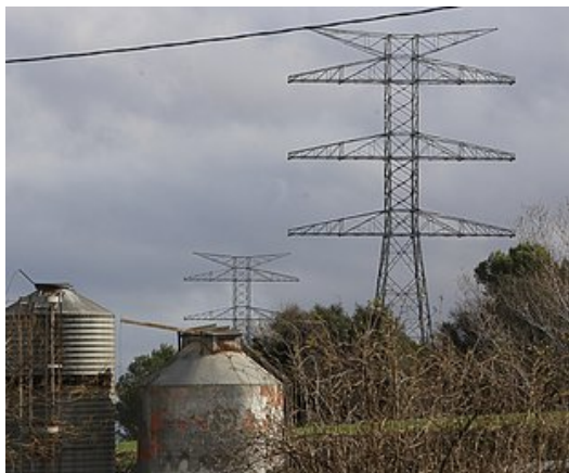
Torres de la línia de molt alta tensió de 400 kV entre Bescanó i Santa Llogaia Foto: M. LLADÓ.
