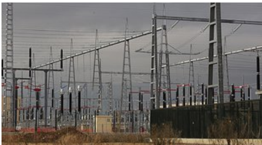
Zona de les subestacions de la MAT a Santa Llogaia Foto: MANEL LLADÓ.
