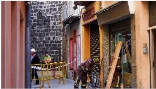
Els Bombers treballen en l'enfonsament de l'edifici.
