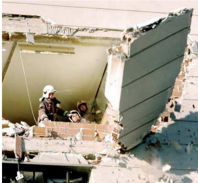
Explosió de gas a Cornellà de Llobregat. / TONI GARRIGA
