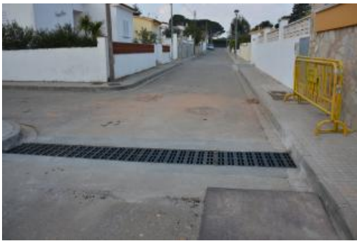
Una de les noves instal·lacions pluvials.
