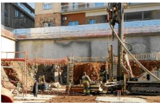
Quatre pous de geotèrmia i una màquina de perforar al subterrani de la plaça Mercat d'Olot.
