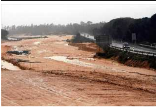
Obres aturades al tram de la N-II que va de Sils a Maçanet.
