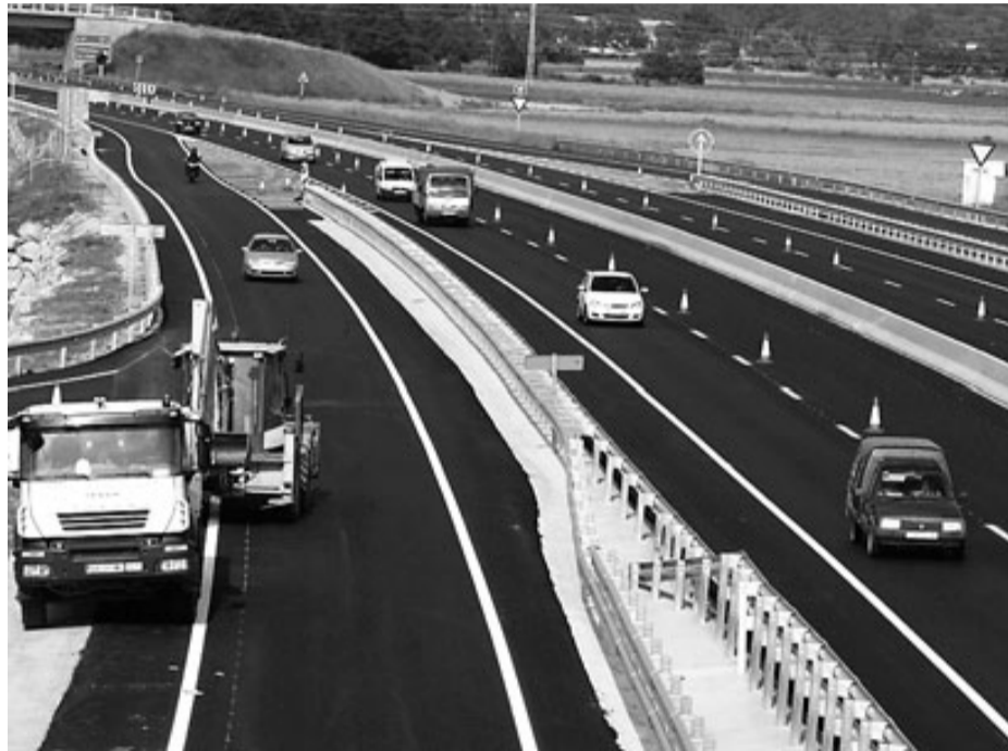
Les obres de la C-35, ahir a la tarda, que ja són al tram final. / LLUÍS SERRAT
