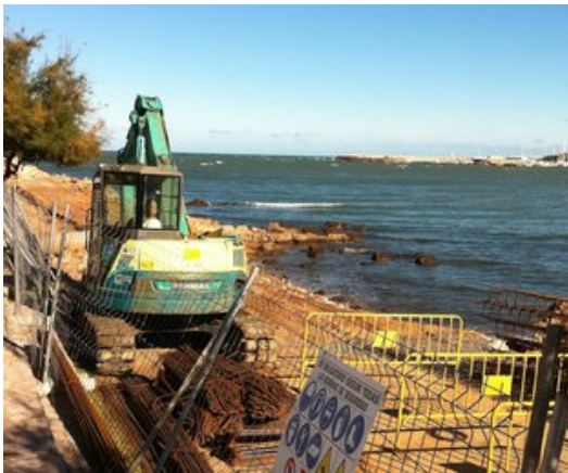
Obres de construcció del tros de passeig nou a l'Escala que unirà el Marítim amb el de Riells. Foto: JOAN PUNTÍ.
