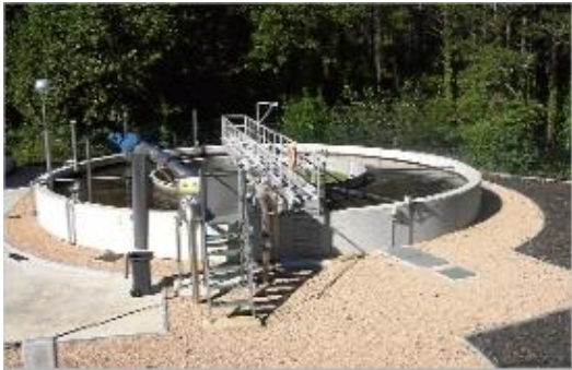
La depuradora que l'ACA ha posat en funcionament a Vidreres.
