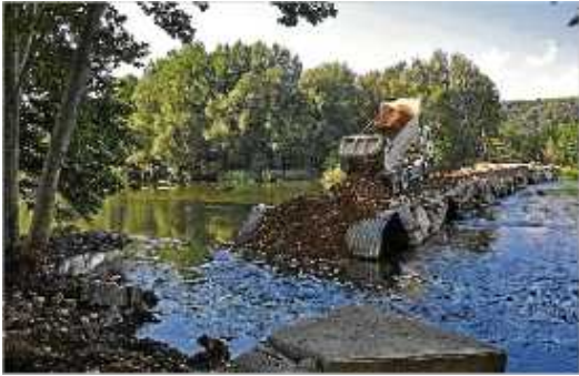
Tram final de les obres a la passera de Bescanó a Sant Gregori.
