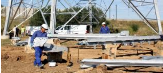
Preveuen 75 torres de la MAT entre Santa Llogaia i Bescanó
