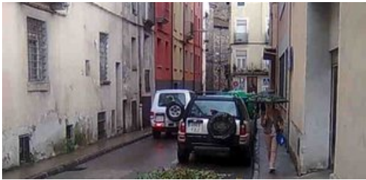
Una vista del tram del carrer Esgleiers, on es duran a terme les obres Foto: J.C.
