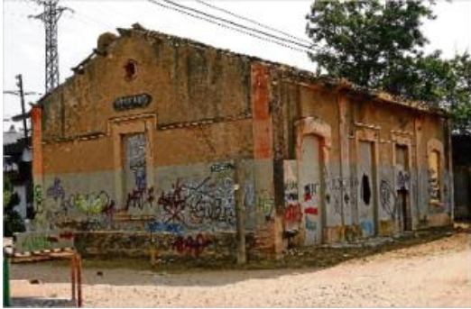
L'estació del Carrilet Girona-Olot a Bescanó, en un estat de deixadesa important.
