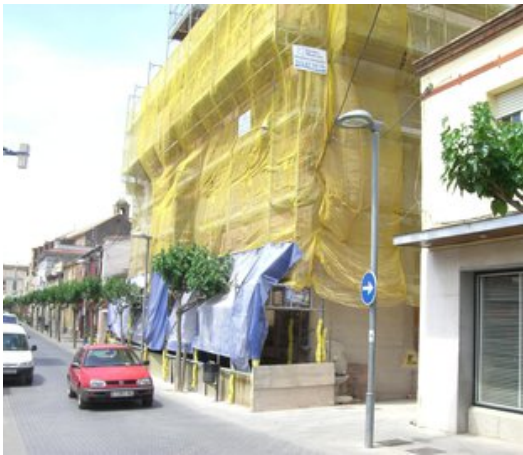
La façana de l'antic Ajuntament de Vidreres, en obres. Foto: J. GONZALO.
