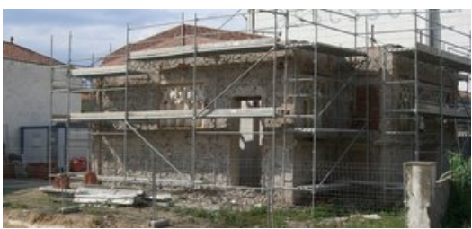
L'antic escorxador de Vidreres es troba en aquests moments en obres de rehabilitació. Foto: JORDI GONZALO.
