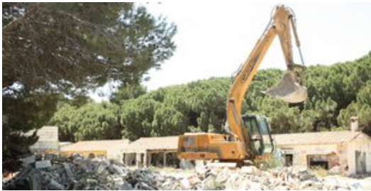
L'enderroc dels edificis militars de les Planasses a l'Escala va començar ahir al matí. Foto: JOAN PUNTÍ.
