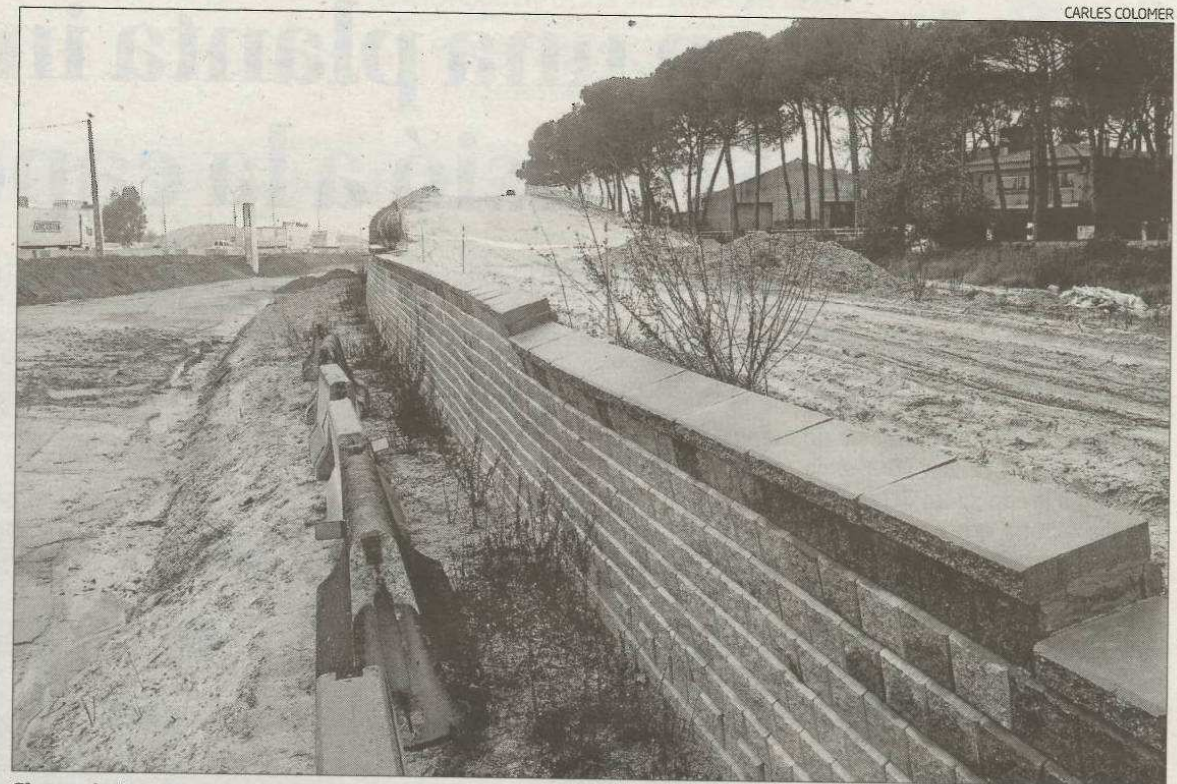
El mur de la connexió de la N-II amb Caldes, visiblement inclinat.
