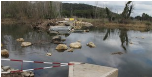
L'estat actual de la passera situat a l'entrada de Bescanó des de Salt, darrere la gasolinera Foto: J.N.
