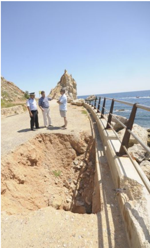
Un esvoranc en la zona del Molinet, sota el cap de la Barra a l'Estartit. Foto: P.A.
