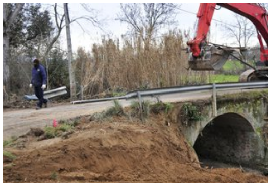
El pont de la Resclosa amb una de les màquines que ja hi treballen Foto: EL PUNT AVUI.
